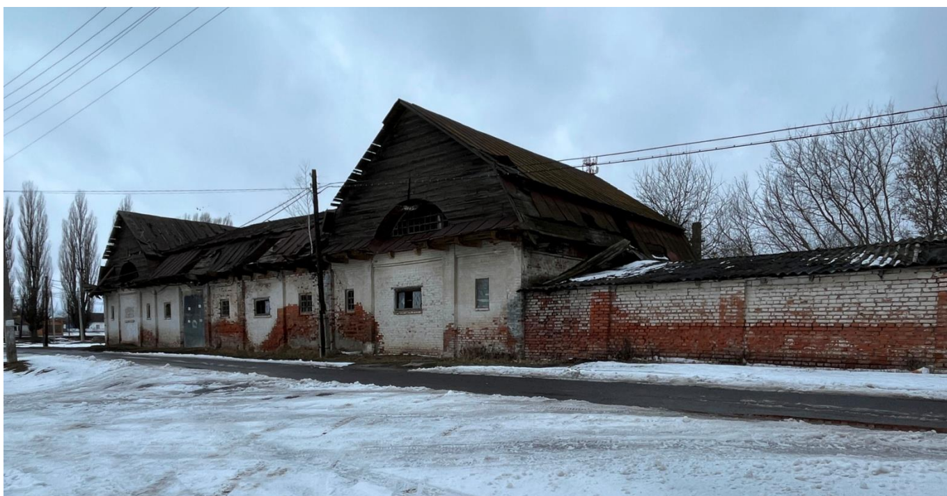
Т.ф. 21. Общий вид дворового фасада инвентарного сарая на территории опытно-селекционной станции в п. Селекционное.
