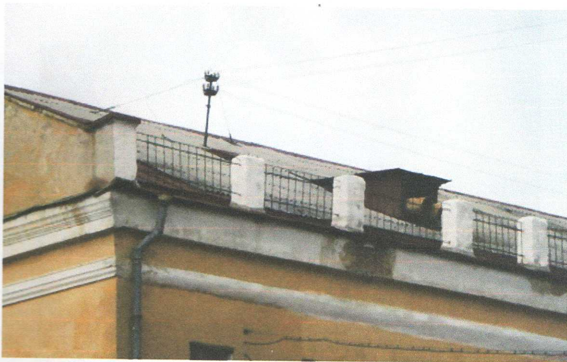
8. «Здание мужской классической гимназии, 1836-1842 гг.», Курская область, г. Курск, ул. Луначарского, 8, литер В, В6. Фото северо-восточного фасада. Состояние кровли. Коррозия металлических элементов. Сентябрь 2015 г.
