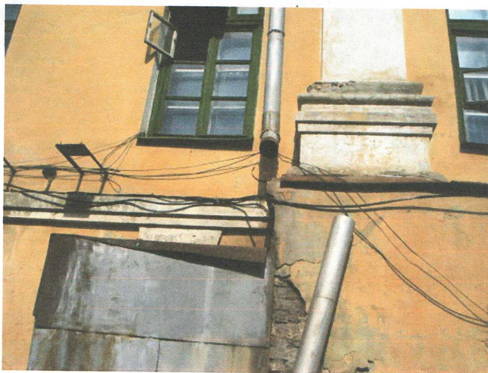
10. «Здание мужской классической гимназии, 1836-1842 гг.», Курская область, г. Курск, ул. Луначарского, 8, литер В, Вб. Фото юго-западного фасада. Состояние водосточной трубы. Разрушение металлических элементов. Сентябрь 2015 г.
