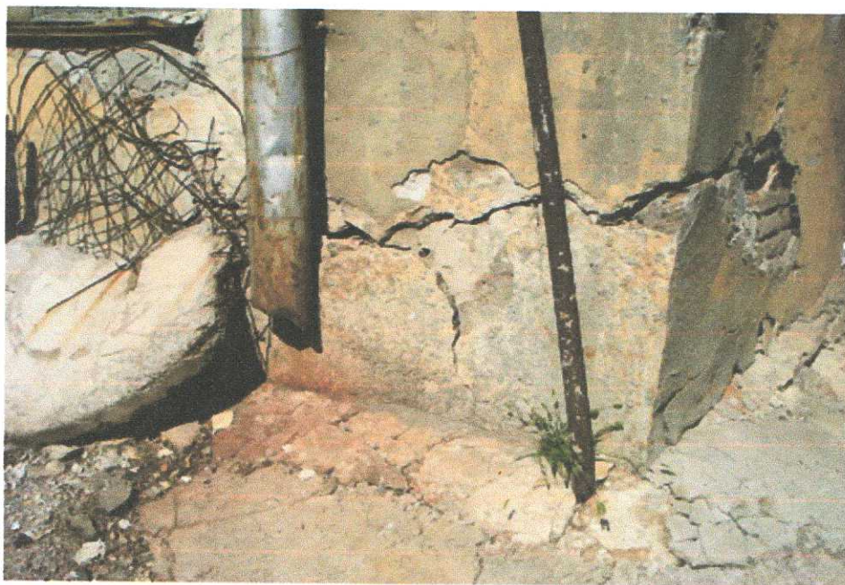
2. «Здание мужской классической гимназии, 1836-1842 гг.», Курская область, г. Курск, ул. Луначарского, 8, литер В. Фото южного угла юго-западного фасада. Состояние цоколя. Трещина, разрушение штукатурного слоя. Трещины и биопоражение отмостки. Сентябрь 2015 г.
