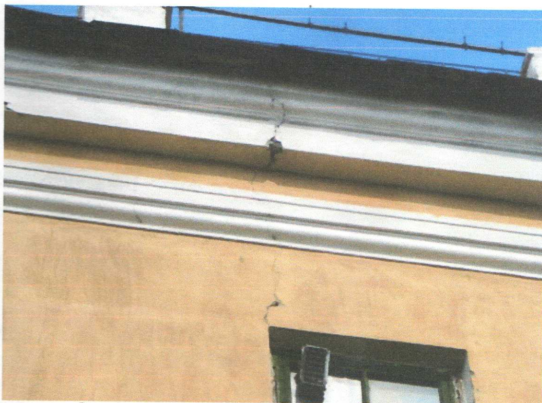
6. «Здание мужской классической гимназии, 1836-1842 гг.», Курская область, г. Курск, ул. Луначарского, 8, литер В. Фото юго-западного фасада. Состояние стен. Трещина. Сентябрь 2015 г.
