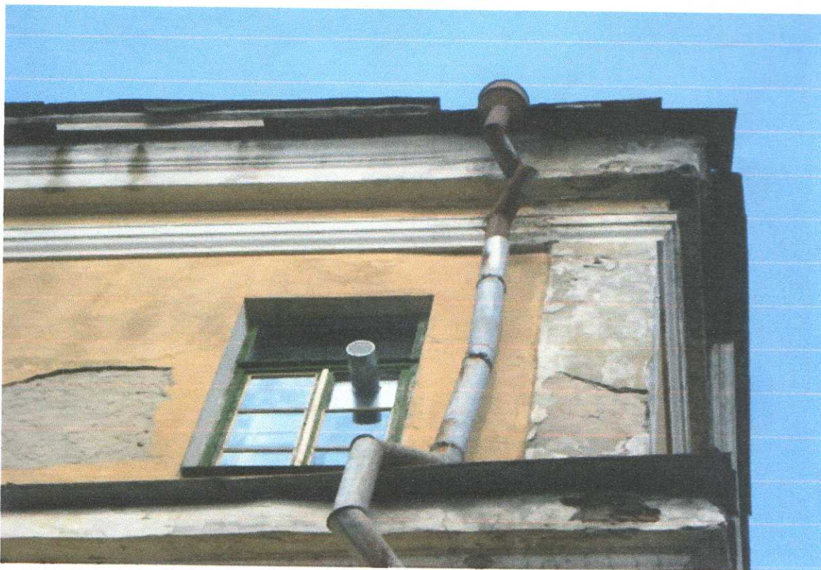
9. «Здание мужской классической гимназии, 1836-1842 гг.», Курская область, г. Курск, ул. Луначарского, 8, литер В, Вб. Фото юго-западного фасада. Состояние водосточной трубы. Коррозия и разрушение металлических элементов. Сентябрь 2015 г.
