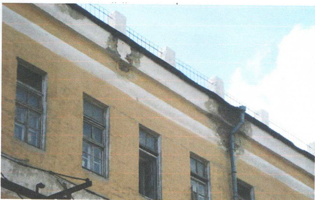
4. «Здание мужской классической гимназии, 1836-1842 гг.», Курская область, г. Курск, ул. Луначарского, 8, литер В. Фото северо-восточный фасад. Состояние стен. Разрушение штукатурного слоя в результате замокания. Сентябрь 2015 г.
