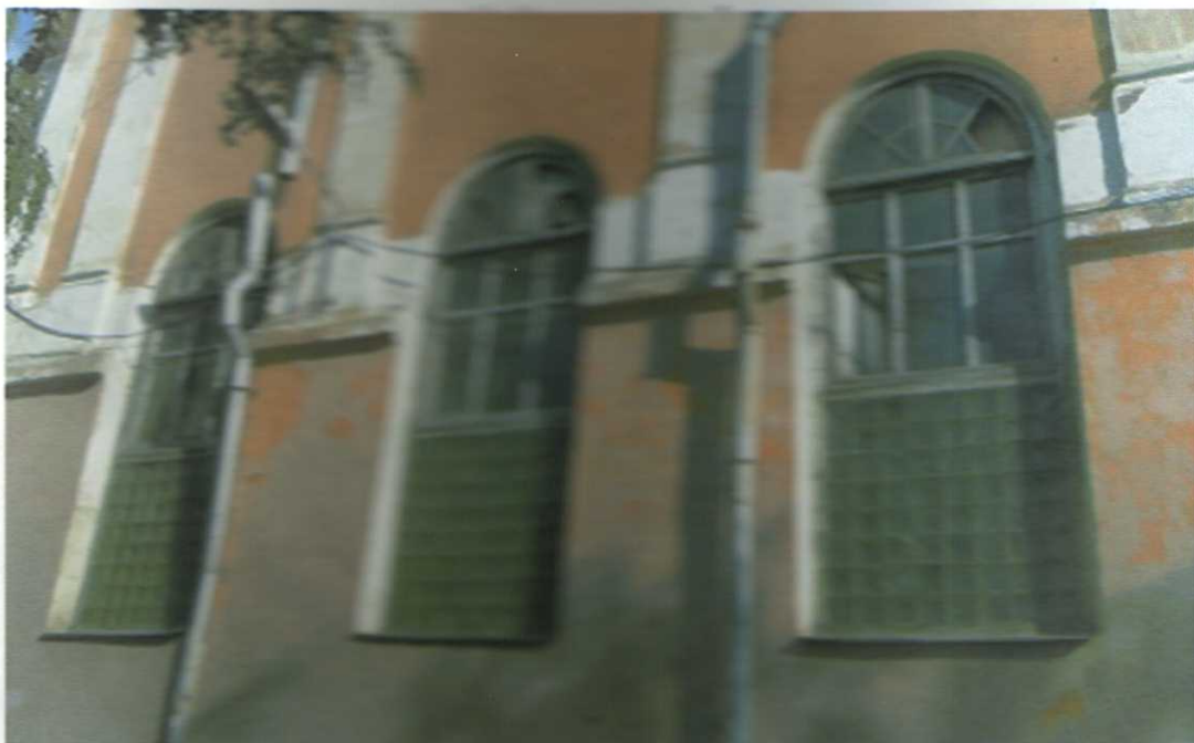
18. «Здание мужской классической гимназии, 1836-1842 гг.», Курская область, г. Курск, ул. Луначарского, 8, литер В, 36. Юго-западный фасад. Система деревянных оконных ставней. Сентябрь 2015 г.
