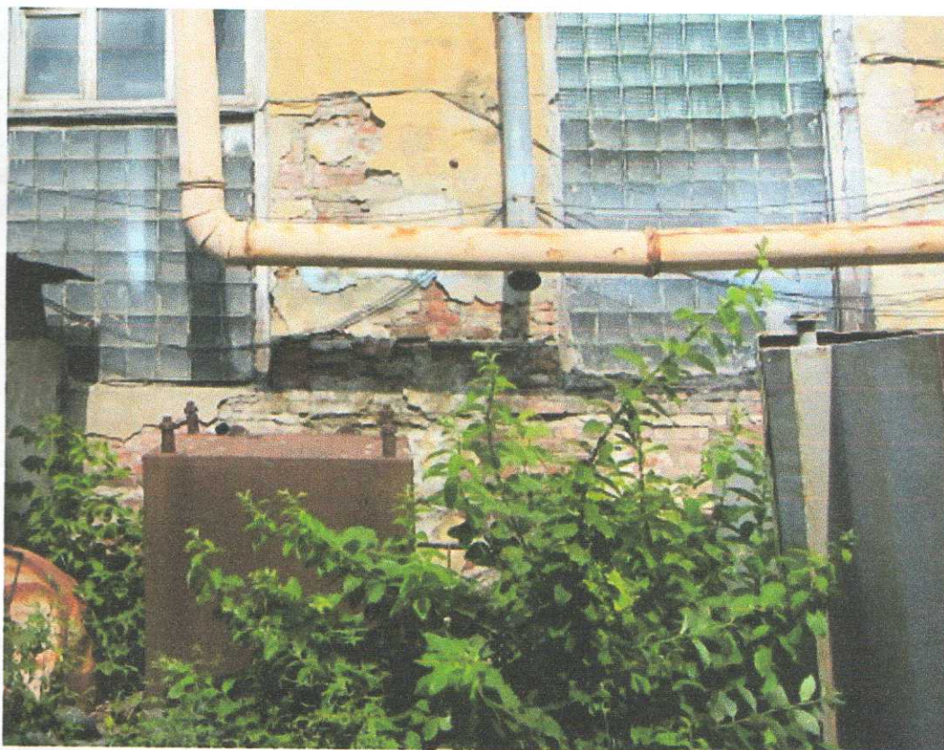
3. «Здание мужской классической гимназии, 1836-1842 гг.», Курская область, г. Курск, ул. Луначарского, 8, литер В. Фото северной части юго-западного фасада. Состояние цоколя. Разрушение штукатурного слоя. Обильный рост самосева по отмостке. Сентябрь 2015 г.
