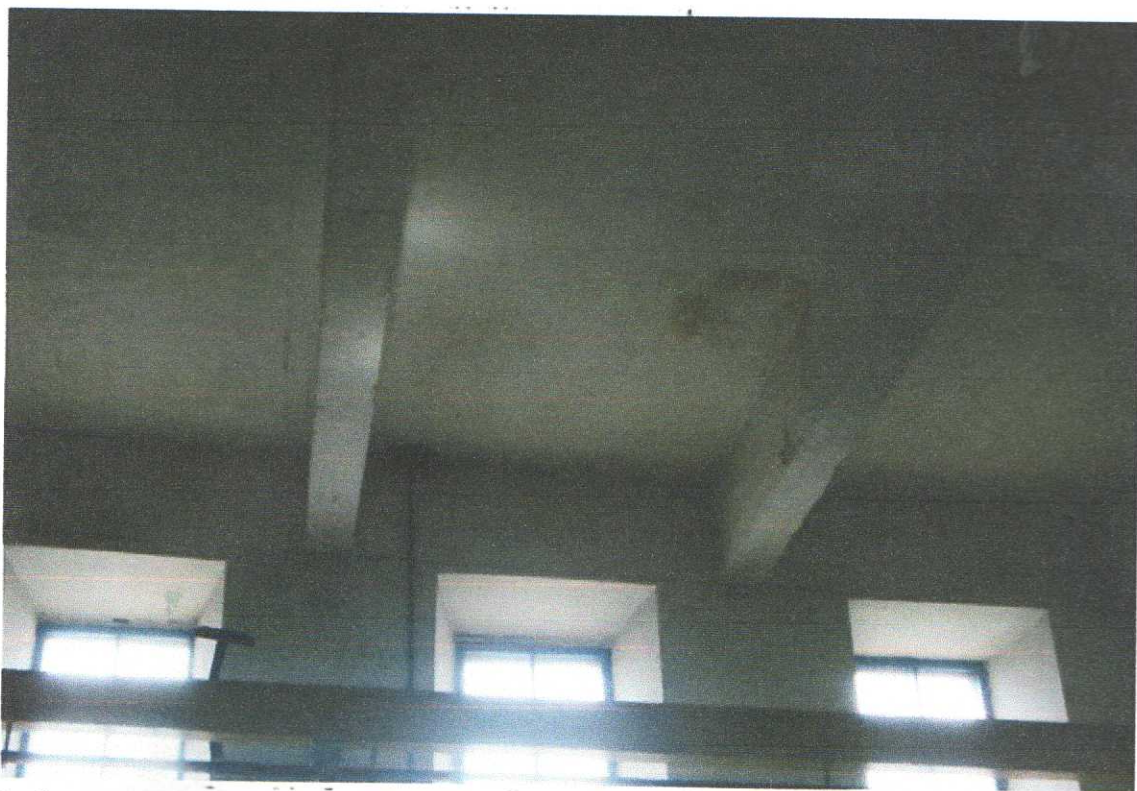
13. «Здание мужской классической гимназии, 1836-1842 гг.», Курская область, г. Курск, ул. Луначарского, 8, литер В, Вб. Интерьер. Состояние плоского бетонного перекрытия по железобетонным балкам. Следы протечки. Сентябрь 2015 г.
