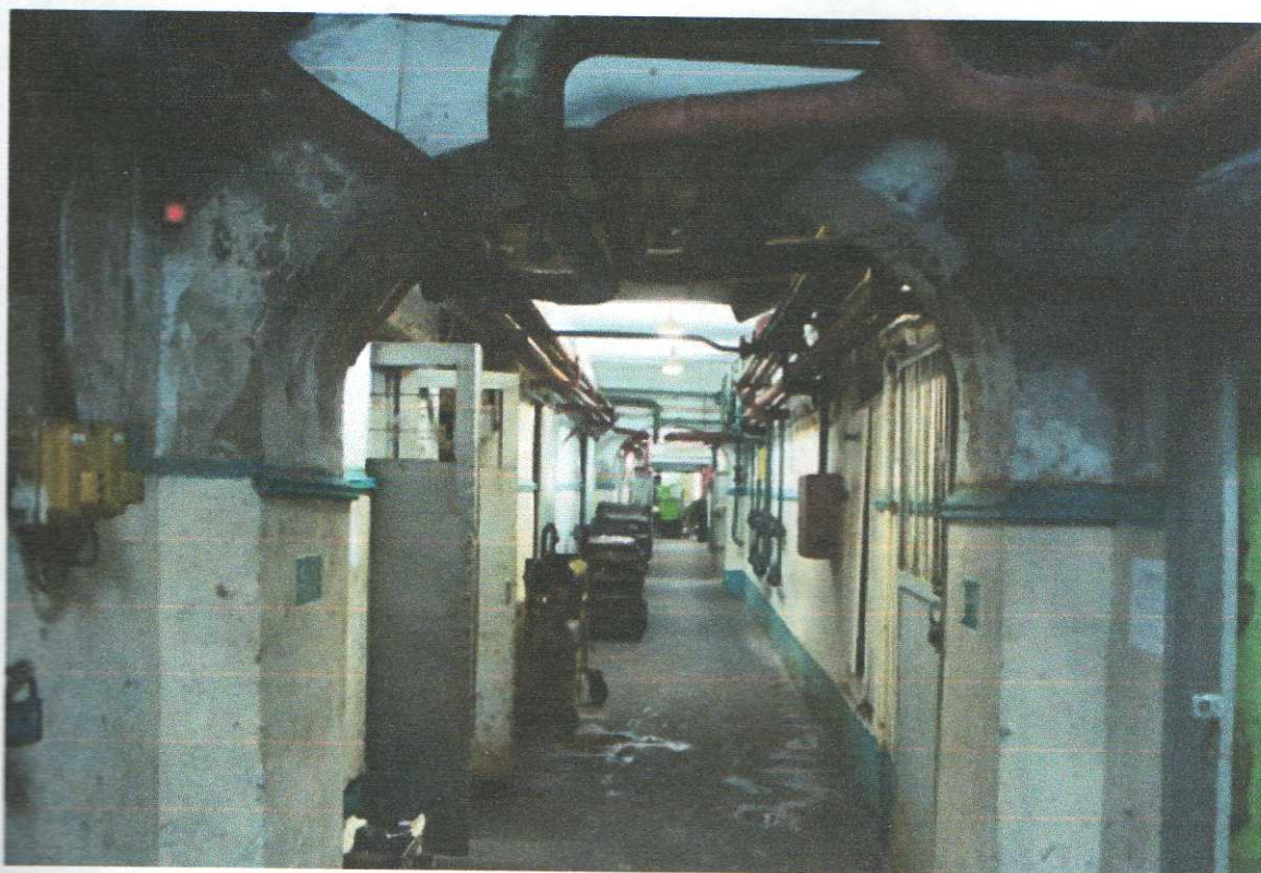
12. «Здание мужской классической гимназии, 1836-1842 гг.», Курская область, г. Курск, ул. Луначарского, 8, литер В, Вб. Интерьер. Состояние стен. Химическая коррозия. Сентябрь 2015 г.
